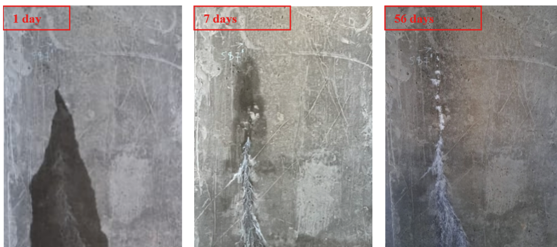
Рис. 13. Масштабированные фотографии состояния трещины № 2 Fig. 13. Scaled photographs of the condition of crack No. 2
