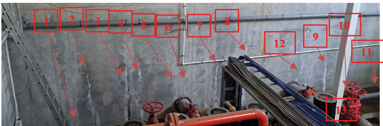
Рис. 12. Фотографии состояния трещин через 56 дней после заполнения резервуара Fig. 12. Photos of the condition of cracks 56 days after the tank filling
