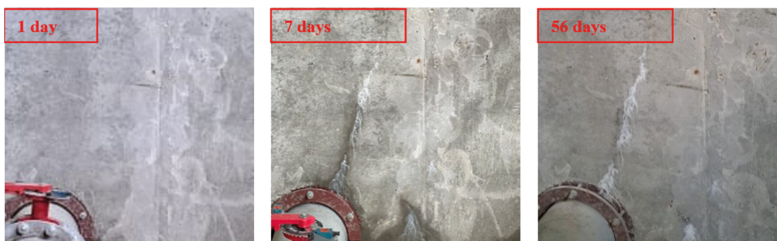
Рис. 14. Масштабированные фотографии состояния трещины № 2 Fig. 14. Scaled photographs of the condition of crack No. 2
