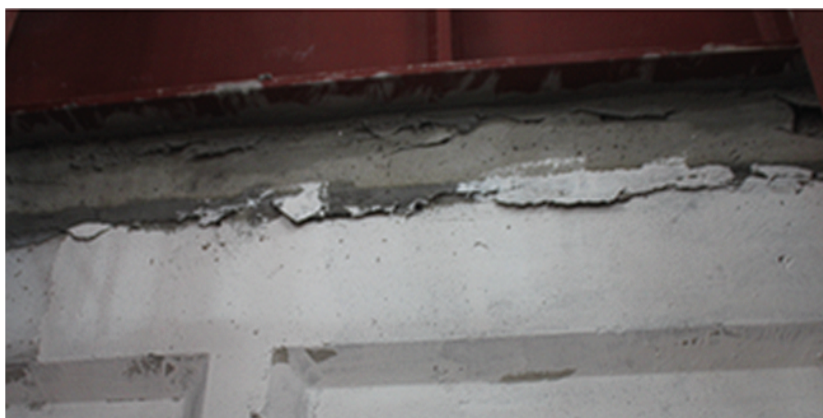
Рис. 5. Повреждения участков сопряжения стен и плиты потолка Fig. 5. Damage of the wall and ceiling plate interface areas
