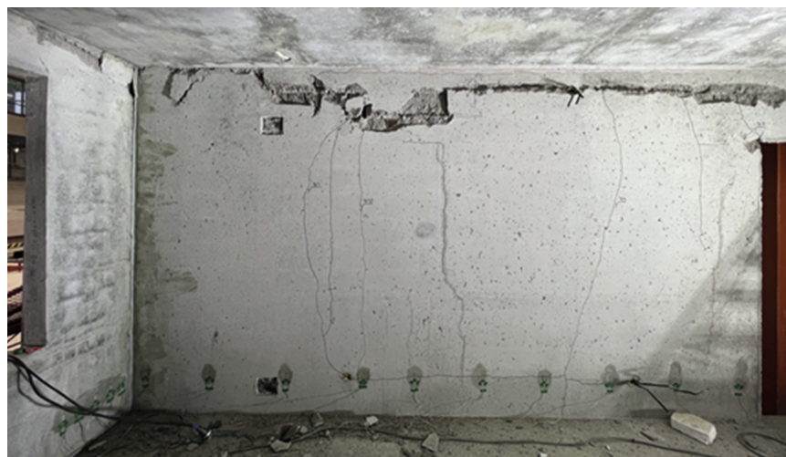
Рис. 8. Разрушение стен объемного блока № 2 Fig. 8. The destruction of the walls of the volumetric block No. 2
