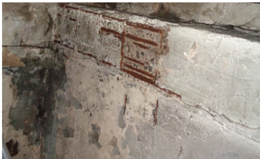
Рис. 2. Бурятия, г. Улан-Удэ, перекрытие подвала школы № 29. Постройка 1937 г. Гладкая арматура оголена в середине изделия. Фото сделано автором в 2015 г.
