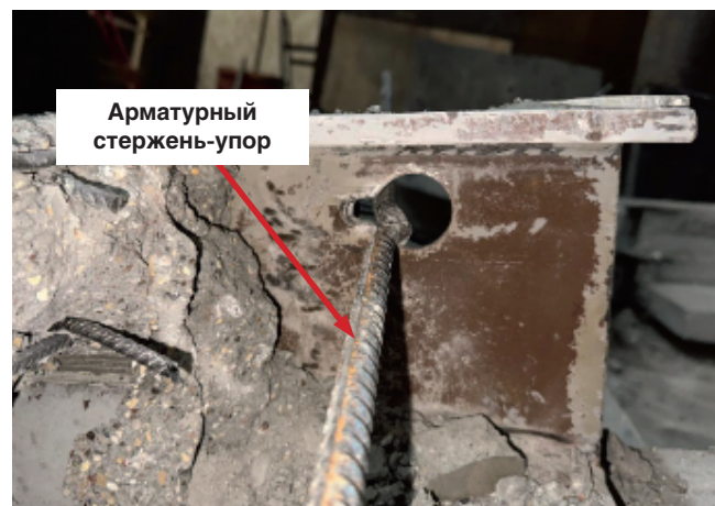
Рис. 6. Смятие стального профиля, изгиб / срез стержня-упора Fig. 6. Crumpling of the steel profile, bending/cutting of the stop rod
