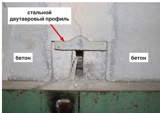
Рис. 5. Сдвиг стального профиля относительно тела бетона Fig. 5. Shift of the steel profile relative to the concrete body
