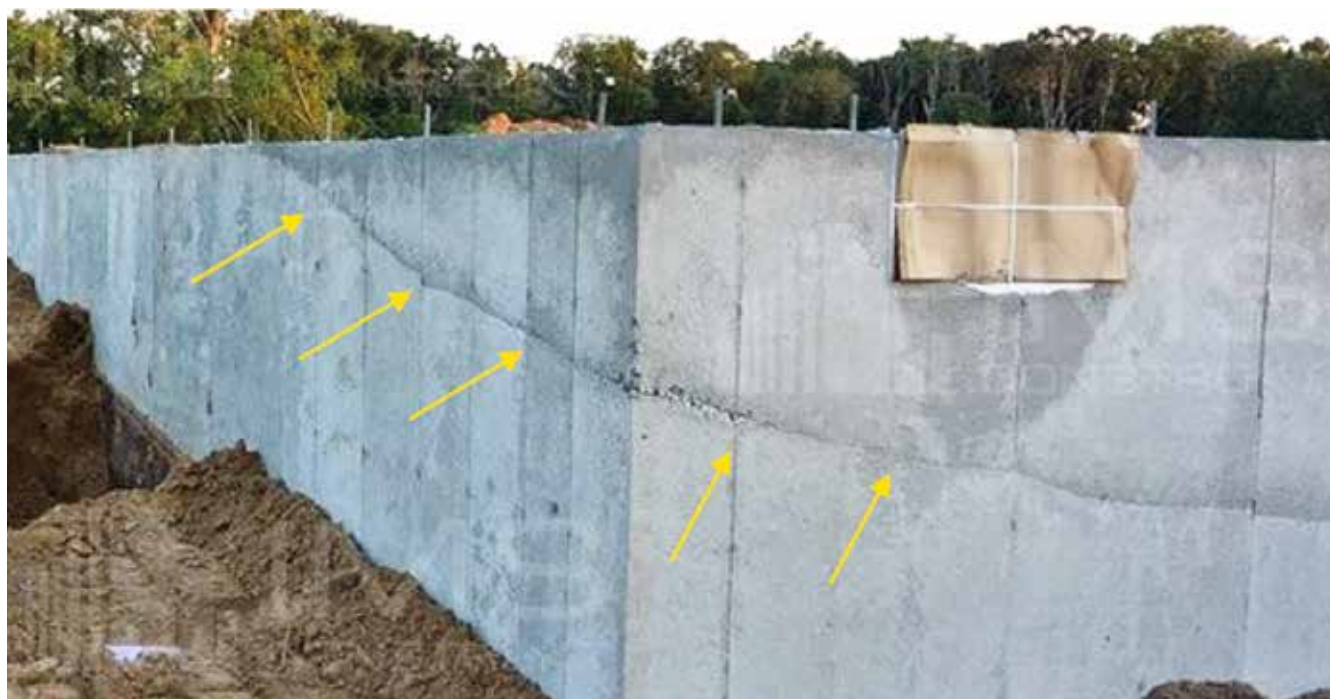
Рис. 1. Пример дефекта забетонированной стены цоколя с признаками образования «холодного шва» бетонирования Fig. 1. Example of a defect in a concreted basement wall with signs of formation of a "cold seam" of concreting
